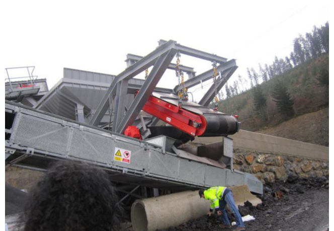
FIGURA 3. SEPARACIÓN DE FRACCIONES METÁLICAS
